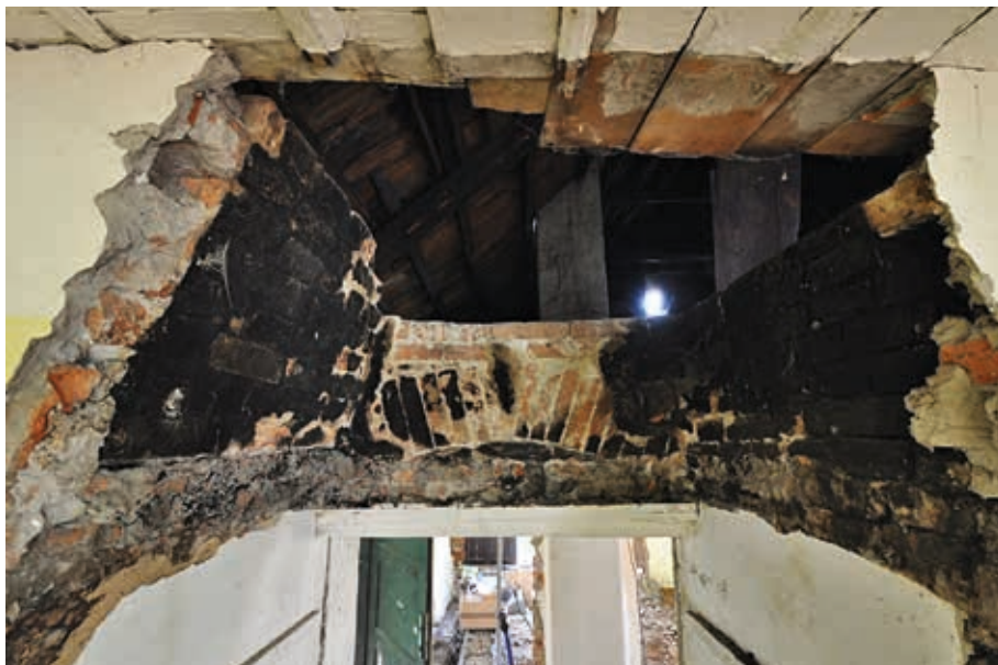
Relikty cihelného zdiva ubouraného průlezného komína nad bývalou černou kuchyní domu čp. 383 (foto D. Alterová, srpen 2017).
