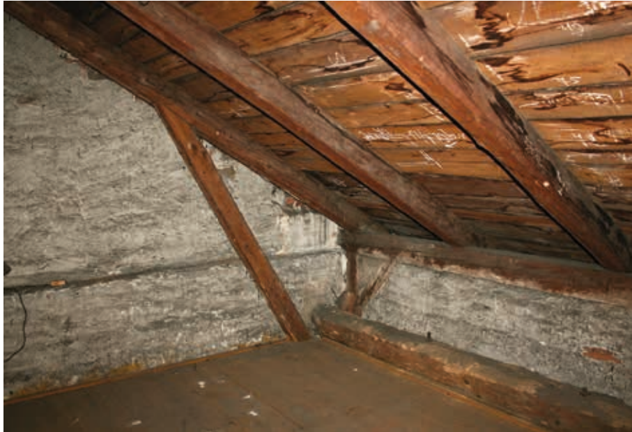
Fara v Kravařích, podkroví, detail hrázděného zesílení horního patra (foto L. Augustinková, 2009).
